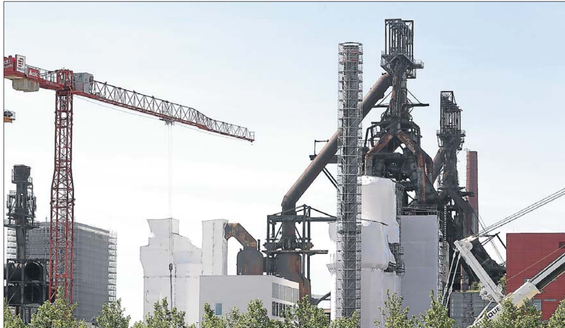
Eingewickelt in weiße Schutzfolie, wird der Hochofen B derzeit gesäubert und erhält anschließend einen neuen Anstrich. (FOTOS: SERGE WALDBILLIG)
